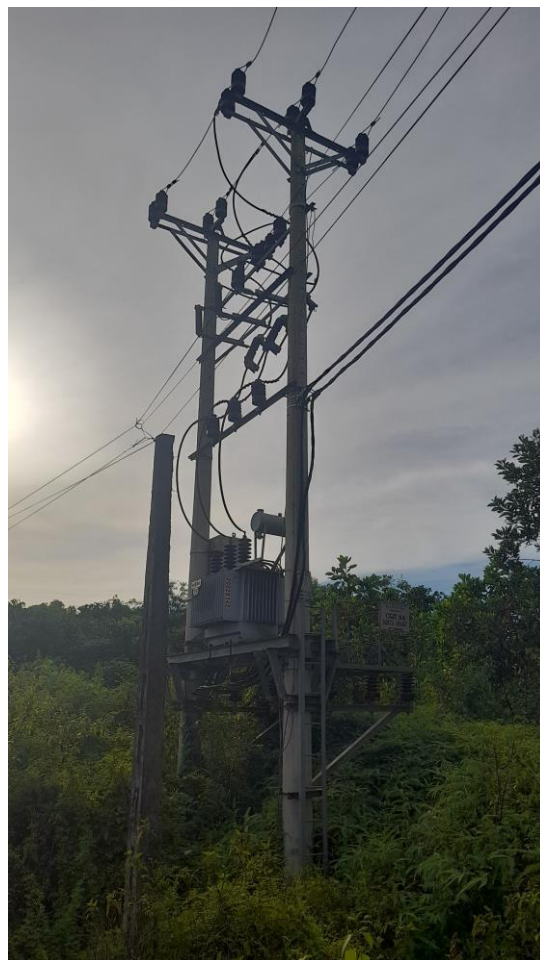
Trạm biến áp CQT8A
