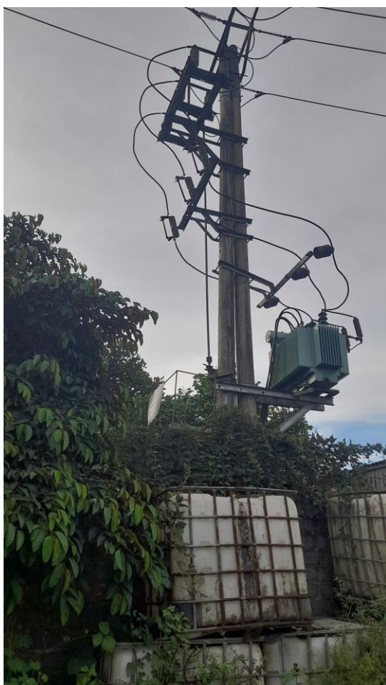
Trạm biến áp Trần Thanh Tuấn 3
